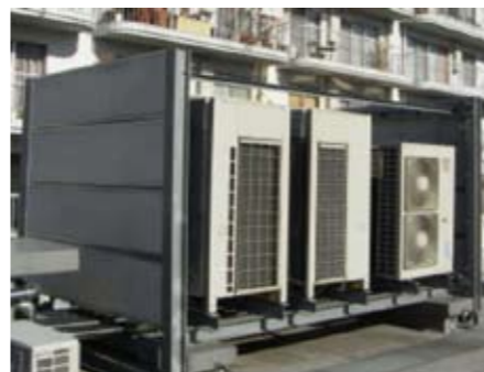
一定規模以上の冷凍室外機は特定施設に該当します
